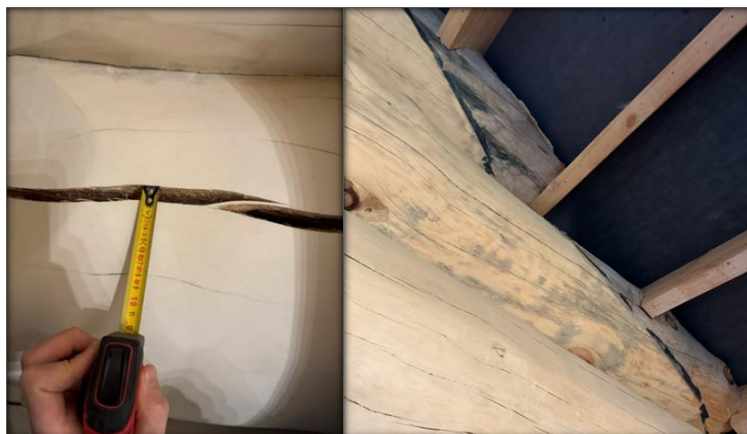
Рис. 5. Трещины и биопоражения древесины
