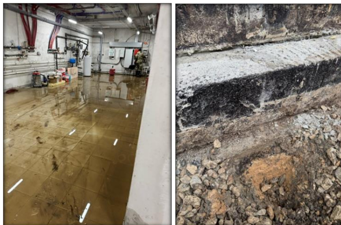
Рис. 3. Следствие некачественных гидроизоляционных работ
