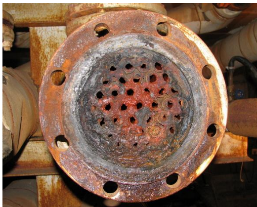
Рис. 1. Загрязнение теплообменного устройства
