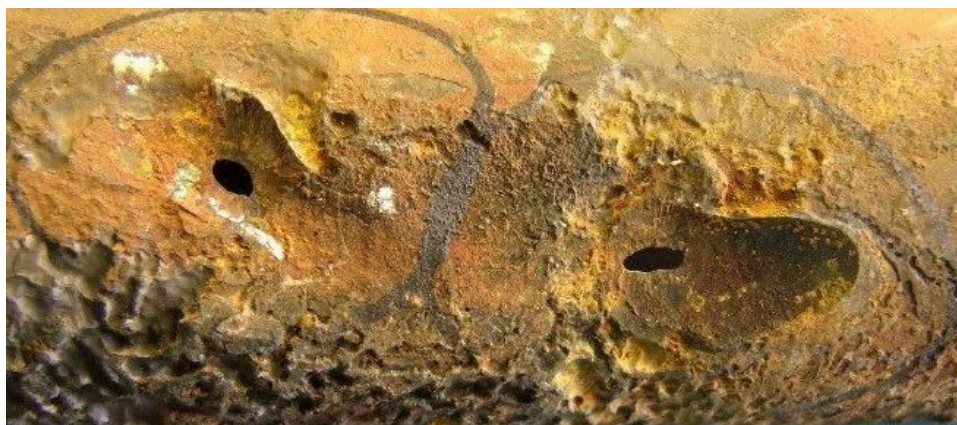
Рис. 1. Фото участка с местной коррозией
