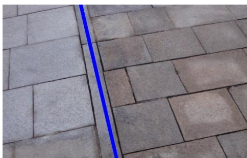
Рис. 4. Изображения до и после очистки объекта с ржавчиной
