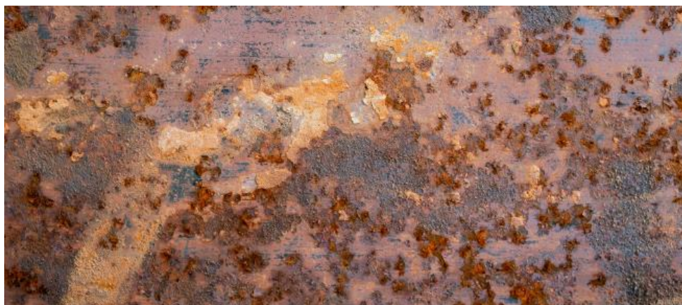
Рис. 2. Фото участка с общей коррозией
